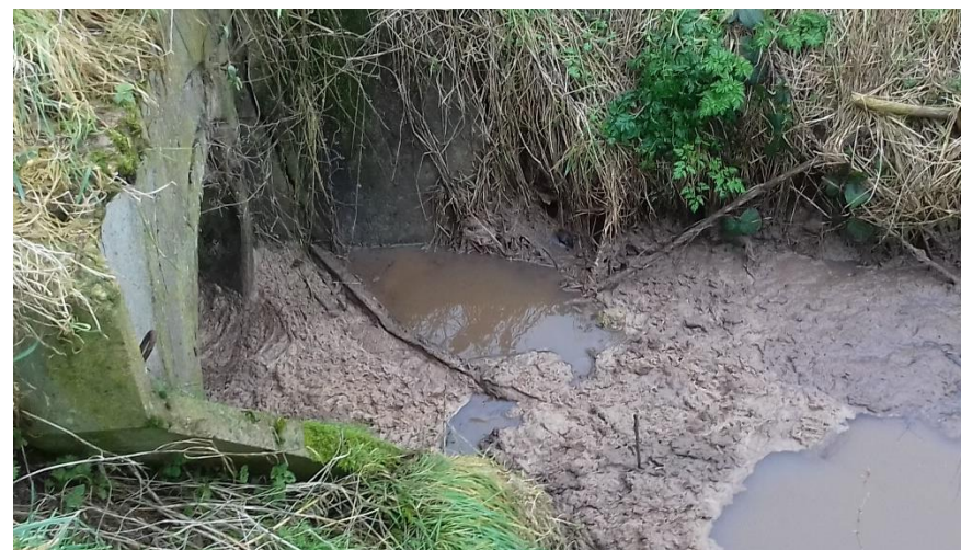
Figure 2 : Désordre des boues dans le fossé
